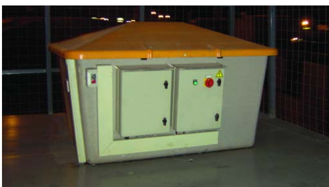
Рис. 1. Мини-насосная станция, монтируемая на небольших, но опасных с точки зрения гололедообразования участках
