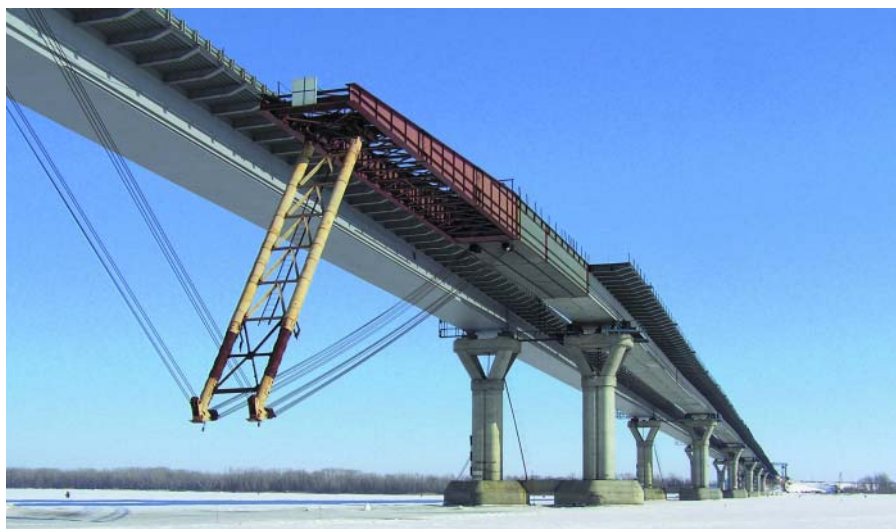
Рис. 1. Момент надвигки пролетного строения 2-й очереди моста через р. Волгу у с. Пристанное
