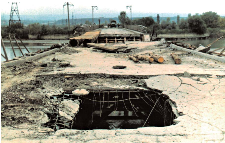
Вид разрушенного пролетного строения моста через р. Терек на дороге Моздок — Грозный у станции Червленная
