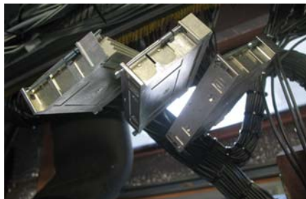
Сеть TCN (Train Communication Network) в кабине водителя
