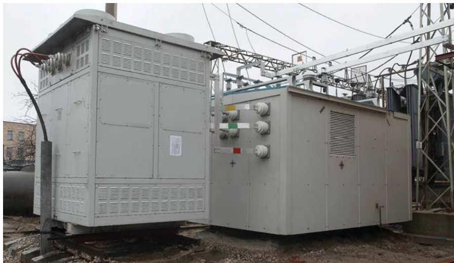
Рис. 6. Вольтодобавочная установка регулируемого напряжения
