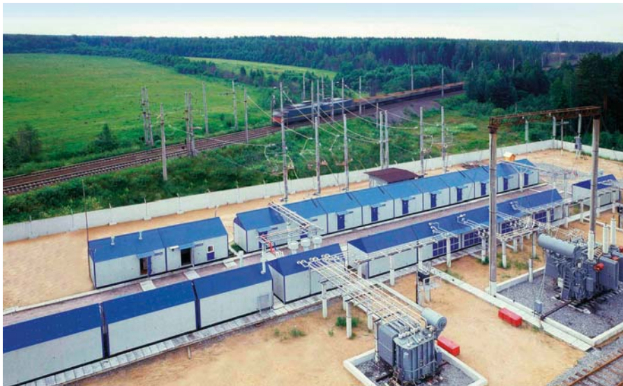
Рис. 3. Типовая модульная тяговая подстанция
