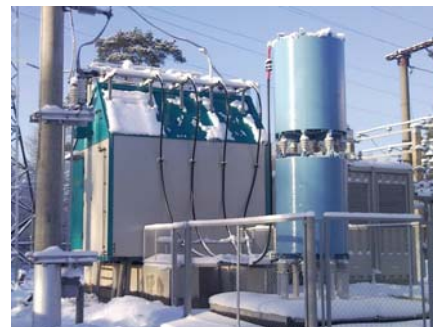
Рис. 7. Преобразователь для системы питания линии постоянного тока 6,6 кВ, установленный на тяговой подстанции
