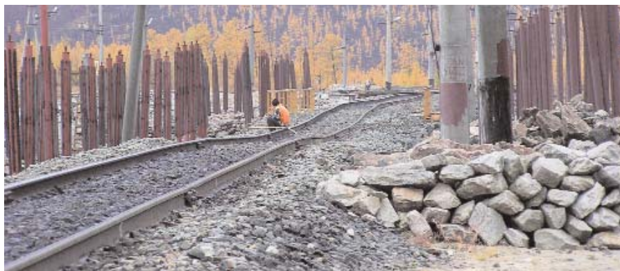
Рис. 2. Участок многолетних деформаций пути и опор контактной сети БАМ, 1374-й км, сентябрь 2003 г. (фото Е.А. Козыревой).
