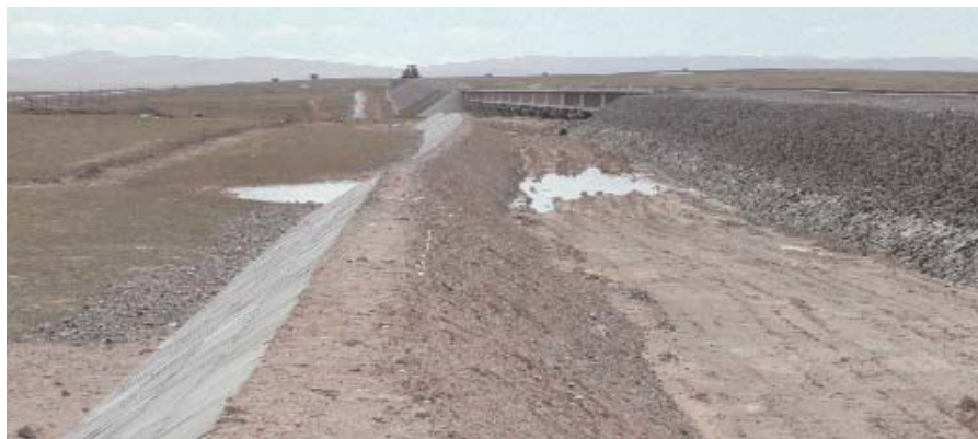
Рис. 5. Деформации земляного полотна Цинхай-Тибетской ж.д. вследствие развития термокарста, август 2004 г.
