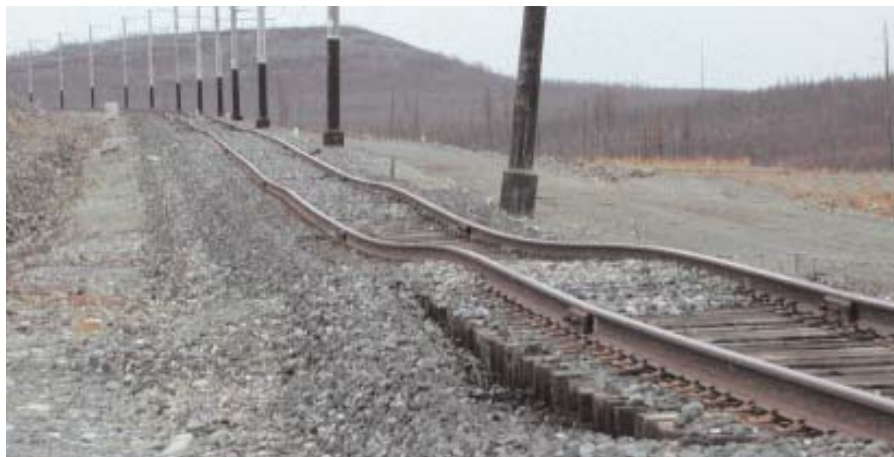
Рис. 3. Деформации подъездного железнодорожного пути Чара — Чина вследствие оттаивания льдистых многолетнемерзлых грунтов в основании, октябрь 2003 г.
