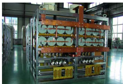
Рис. 1. Один из трех блоков преобразователя, установленного в модуле с суммарной мощностью 6 МВт
