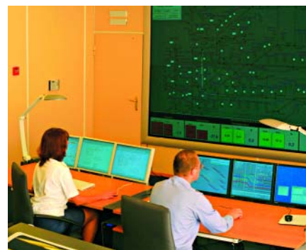
Центр управления ЕК АСУ ППЭ
