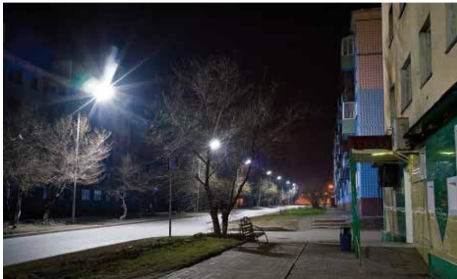
Освещение уличными светодиодными светильниками типа «УСС -120 – Магистраль Ш». Дорога категории В-2, г. Кемерово
