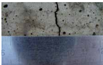
Рис. 6. Трещины на шпалах (крупные и мелкие сетевидные)
