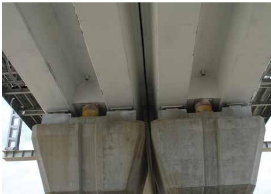
Рис. 5. Демпфирующие устройства на одной из железнодорожных эстакад в г. Сочи
