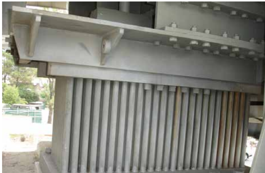
Рис. 3. Стержневой амортизатор, установленный на одном из съездов железнодорожной линии Адлер – Сочи
