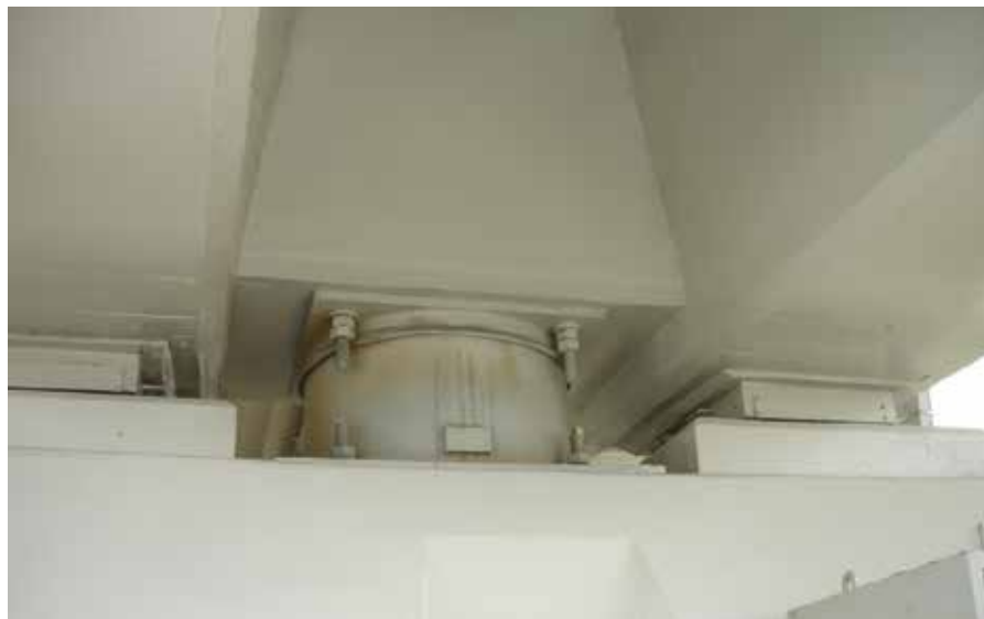
Рис. 4. Вязкий демпфер фирмы «Вибросейсм», установленный на железнодорожной эстакаде в г. Сочи
