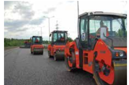
Капитальный ремонт дороги «Ульяновск — Димитровград — Самара». Категория дороги — I, протяженность участка — 8,223 км, число полос — 4, земляные работы — 21 172 м 3 , основание из щебня — 12 414 м 3 , покрытие асфальтобетоном — 26 558 т
