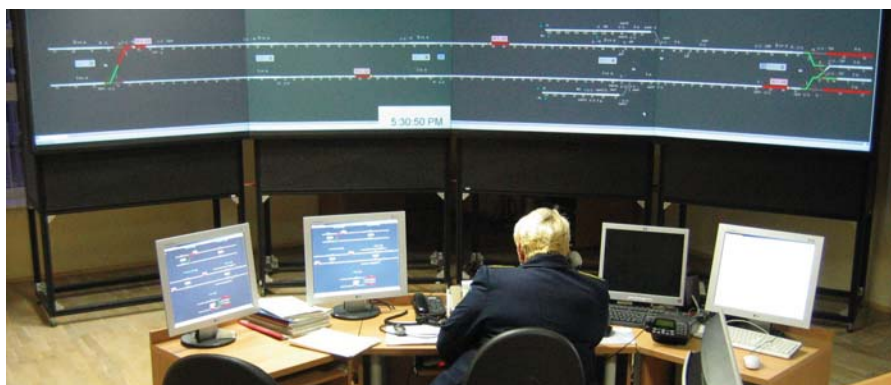
Центральный пост управления движением
