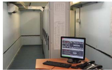
Размещение аппаратуры системы «Движение» в помещении станции
