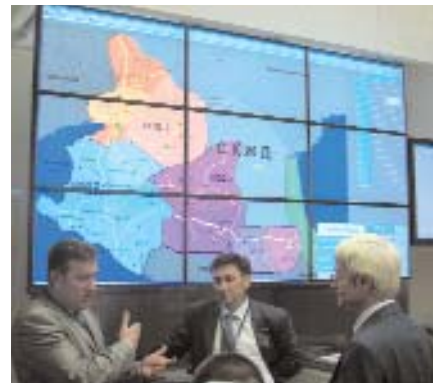
Представитель департамента АТ ОАО «РЖД» Е.А. Гоман, гл. инженер службы АТ СКЖД А.В. Черномазов, зам. директора НПП «Югпромавтоматизация» А.А. Сепетый в дорожном диспетчерском центре технического диагностирования и мониторинга СКЖД.
