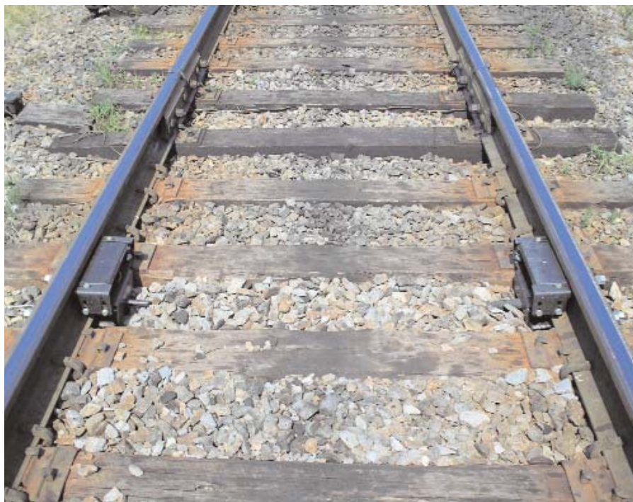
ЭССО — микропроцессорная система контроля свободы участков железнодорожного пути методом счета осей.
