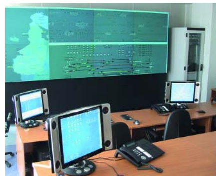
Дорожный центр технической диагностики и мониторинга устройств автоматики и телемеханики
